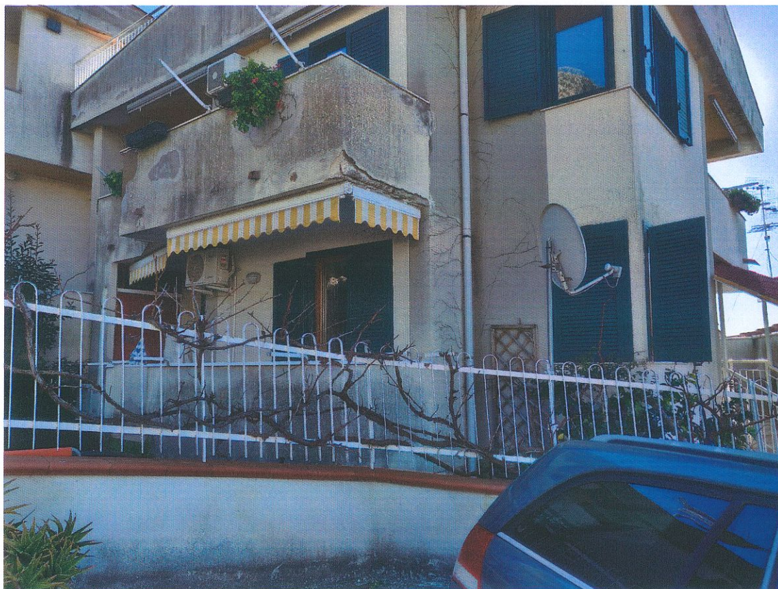
Foto 18 – Vista delle facciate con segni di degrado
